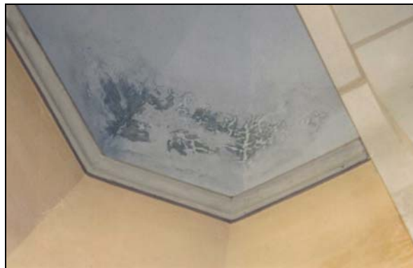
Figura 21: forro de uma cúpula com manchas de umidade por infiltração
