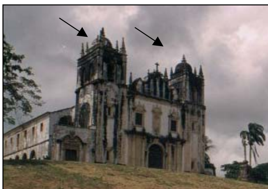
Figura 25: efeitos da presença de microrganismos e da poluição sobre as fachadas
