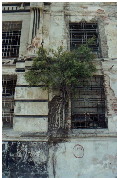
Figura 27: desenvolvimento de vegetação de médio porte sobre a fachada de uma edificação
