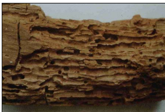
Figura 28: aspecto da madeira atacada por cupins (MERINO, 1991)
