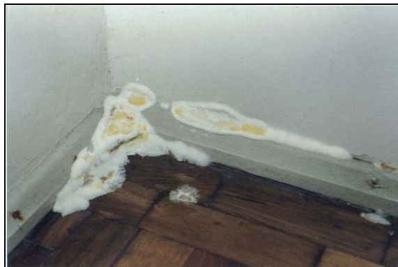
Figura 24: colônia de fungos desenvolvendo-se junto ao rodapé
