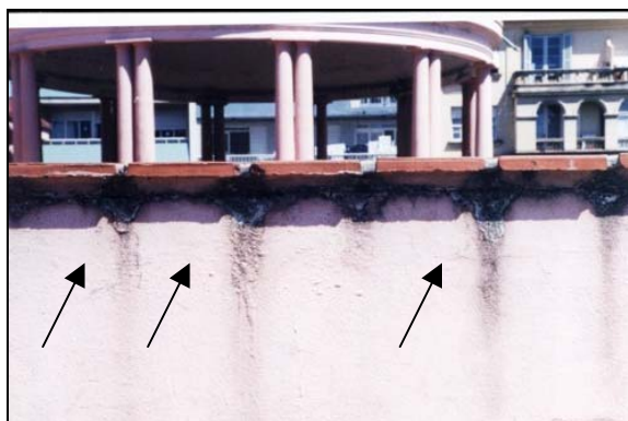
Figura 23: manchas escorridas na fachada
