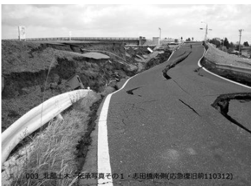
003_北郷七木(石承写真その1・手田橋南側(応急復旧前110312))
