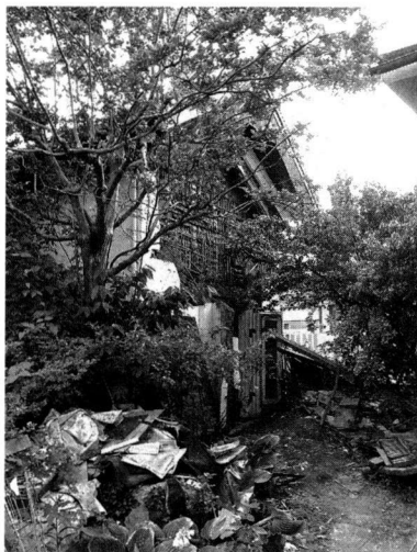
写真1 レスキュー対象の蔵。外壁が崩れている様子や周辺の瓦礫の状況が窺える
