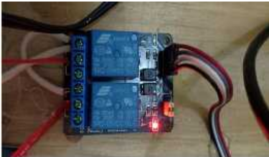
Gambar 11. Relay pada Maket Rumah Pintar
