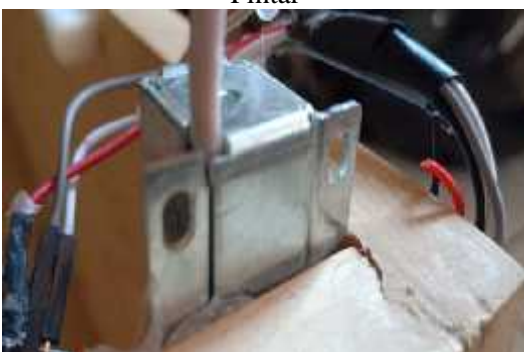
Gambar 15. Door Lock Solenoid pada Maket Rumah Pintar
