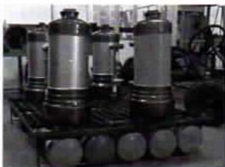
Gambar 2 prototipe instalasi pengolahan air banjir
