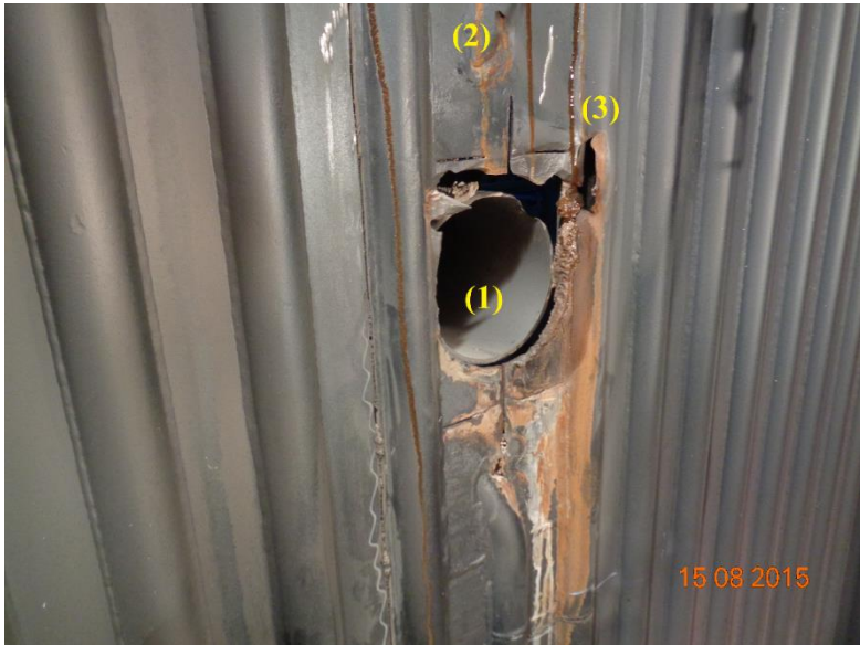
Gambar 1.1 Riser wall tube yang mengalami kegagalan
