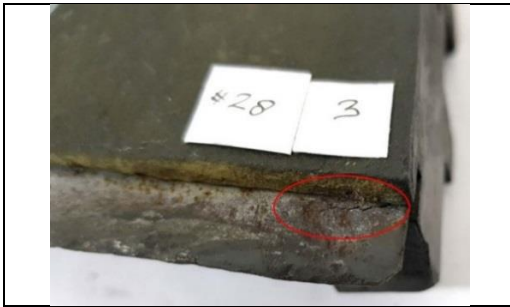
Gambar 4.3 Pengamatan pada Seal Strips Kode 28 yang Mengalami Kegagalan
