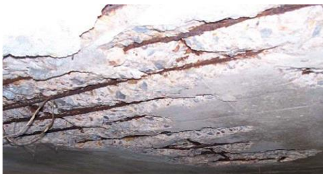
Gambar 2.1. Korosi Pada Beton Bertulang (Dokumentasi pribadi, 2014)
