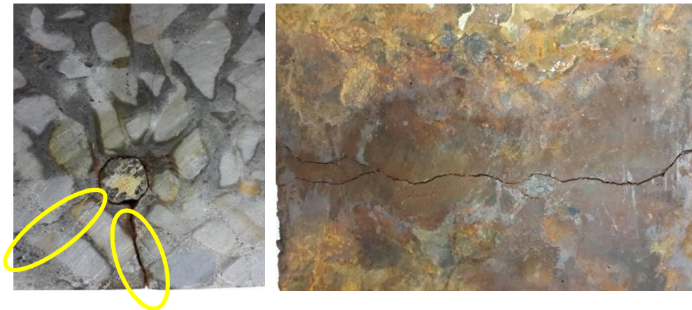
Gambar 5.9 Retak pada penampang hari ke 20
