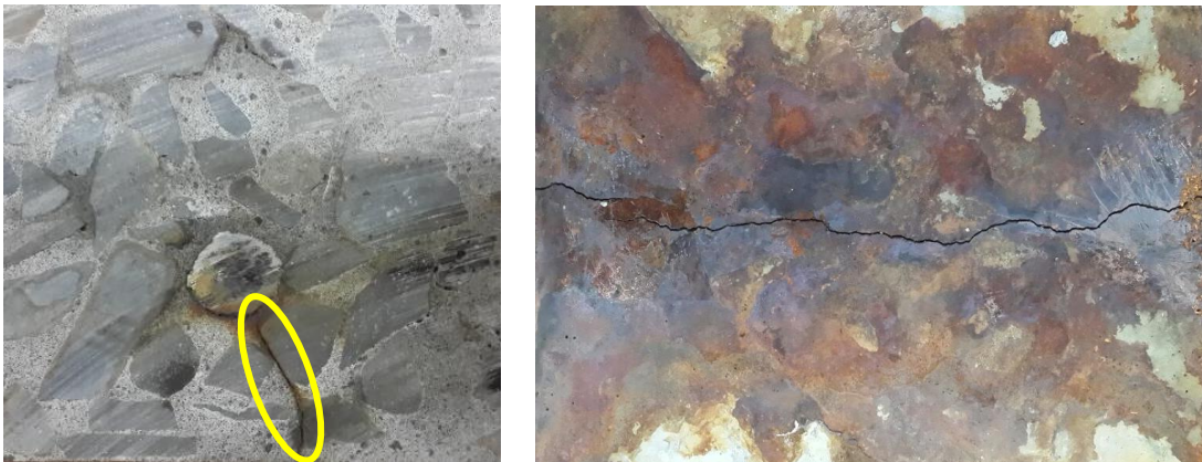
Gambar 5.8 Retak pada penampang hari ke 15
