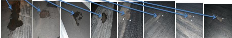
Kerusakan Permukaan Runway (tanggal 11 April 2014) Terjadi kerusakan berupa aspal mengelupas dan lubang Sumber: P.T. Angkasa Pura I
