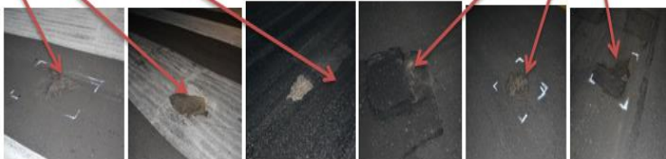
Kerusakan Permukaan Runway (tanggal 16 April 2014) Terjadi kerusakan berupa aspal mengelupas dan lubang Sumber: P.T. Angkasa Pura I
