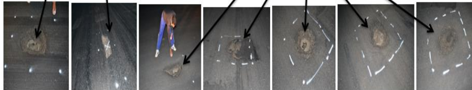
Kerusakan Permukaan Runway (tanggal 06 Maret 2014) Terjadi kerusakan berupa aspal mengelupas dan lubang Sumber: P.T. Angkasa Pura I
