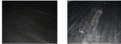
Gambar 4.4 Retak Disertai Penurunan 2cm
