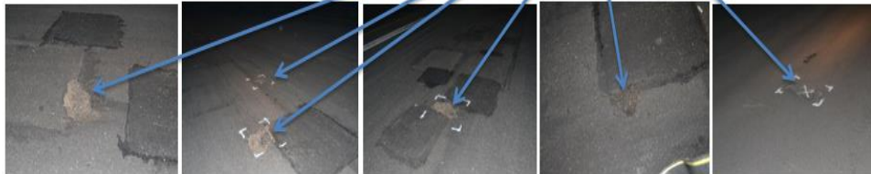
Kerusakan Permukaan Runway (tanggal 07 April 2014) Terjadi kerusakan berupa aspal mengelupas dan lubang Sumber: P.T. Angkasa Pura I
