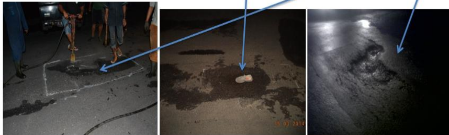
Kerusakan Permukaan Runway (tanggal 17 Maret 2014) Terjadi kerusakan berupa lubang yang cukup lebar dan dalam Sumber: P.T. Angkasa Pura I
