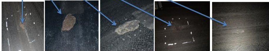
Kerusakan Permukaan Runway (tanggal 11 Maret 2014) Terjadi kerusakan berupa aspal mengelupas dan lubang Sumber: P.T. Angkasa Pura I
