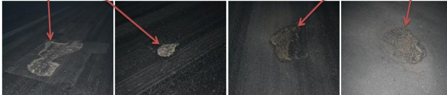
Kerusakan Permukaan Runway (tanggal 21 April 2014)
