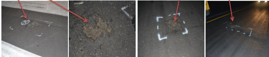
Kerusakan Permukaan Runway (tanggal 08 Mei 2014) Terjadi kerusakan berupa aspal mengelupas dan lubang Sumber: P.T. Angkasa Pura I
