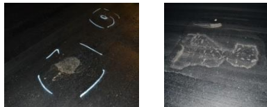
Gambar 4.3 Crack Berjarak Kurang dari 1.27 m (Sumber: PT. Angkasa Pura I)
