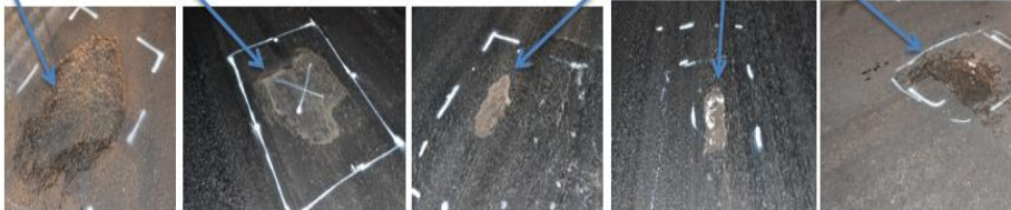
Kerusakan Permukaan Runway (tanggal 10 Maret 2014) Terjadi kerusakan berupa aspal mengelupas, erosi, dan lubang Sumber: P.T. Angkasa Pura I
