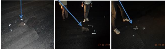
Kerusakan Permukaan Runway (tanggal 21 Maret 2014) Terjadi kerusakan berupa aspal mengelupas dan lubang Sumber: P.T. Angkasa Pura I
