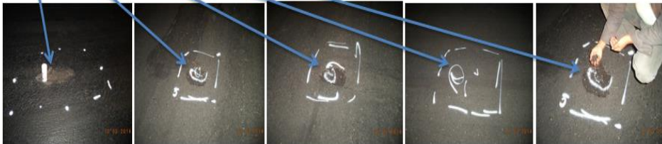
Kerusakan Permukaan Runway (tanggal 09 Maret 2014) Terjadi kerusakan berupa aspal mengelupas dan lubang Sumber: P.T. Angkasa Pura I
