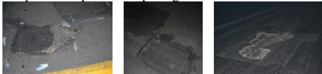
Gambar 4.5 Kerusakan pada Patch dan Utility Cut
