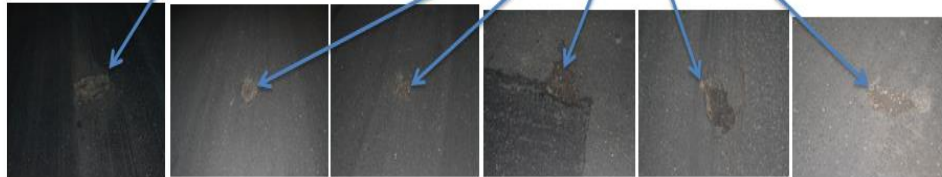
Kerusakan Permukaan Runway (tanggal 02 April 2014) Terjadi kerusakan berupa aspal mengelupas dan lubang Sumber: P.T. Angkasa Pura I
