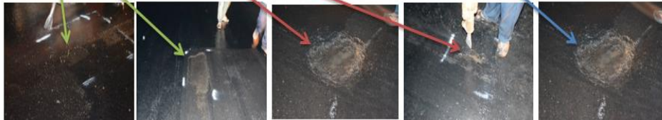
Kerusakan Permukaan Runway (tanggal 27 Februari 2014) Terjadi kerusakan berupa aspal mengelupas dan lubang Sumber: P.T. Angkasa Pura I
