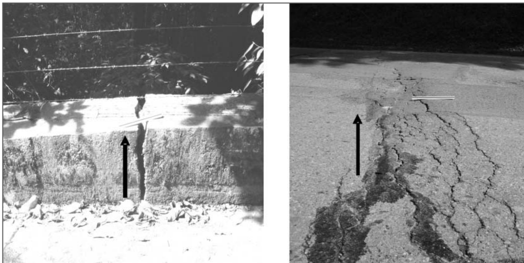
Figura 7. Agrietamiento en bordillos y pavimentos de la vía principal. Obsérvese la dirección de las grietas perpendiculares a la obra
