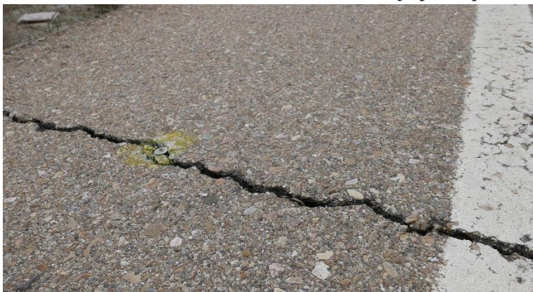
Figura 11:Clavo empleado para la medición de la subsidencia en mal estado debido a la aparición de una grieta en el asfalto por efecto de la subsidencia de la dolina.
