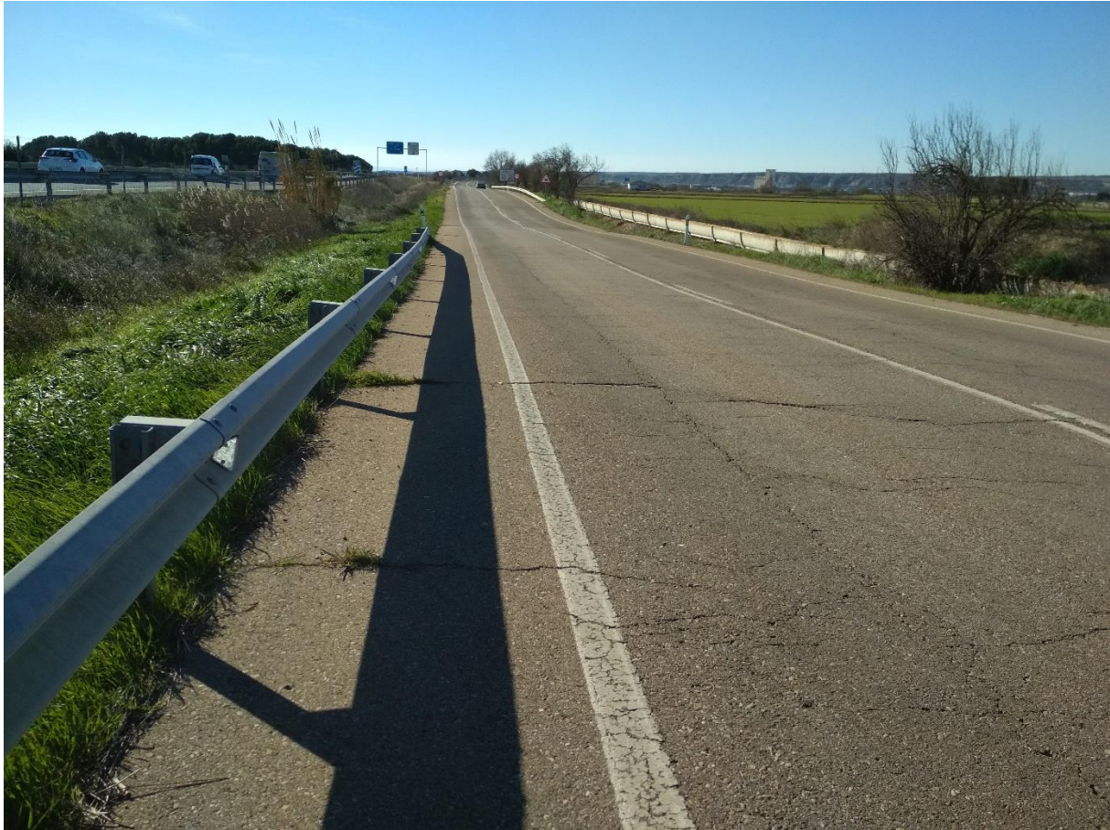
Figura 15: Dolina en la N-330 al Norte de Puilatós. Se aprecian las grietas formadas en el asfalto por el hundimiento de la dolina.
