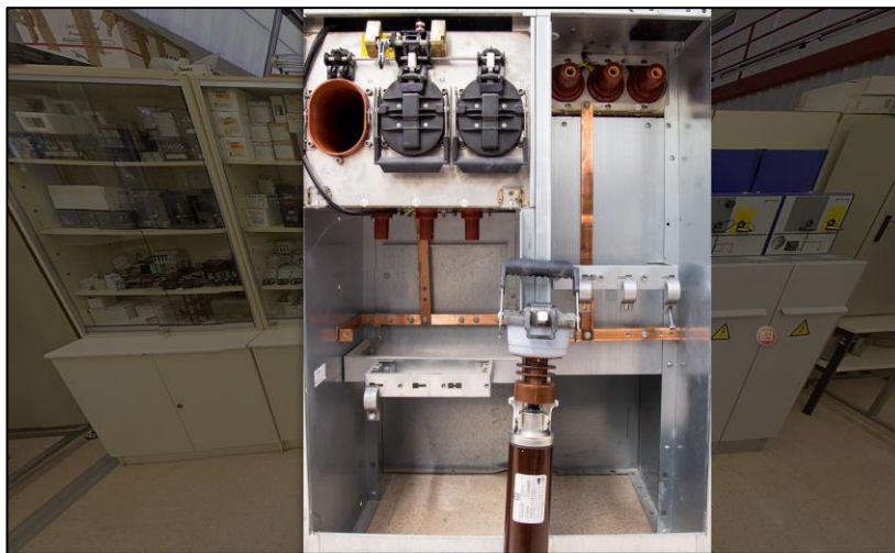
Figura 16: Detalle de la caja de fusibles abierta
