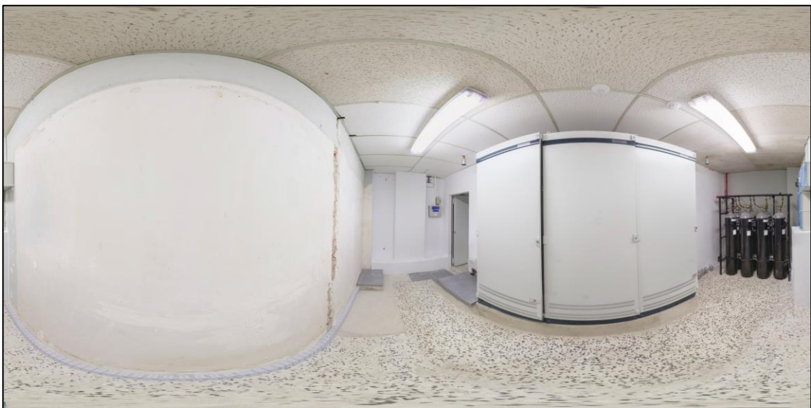
Figuras 41 a 43: Panorámicas de centro de transformación visitado
