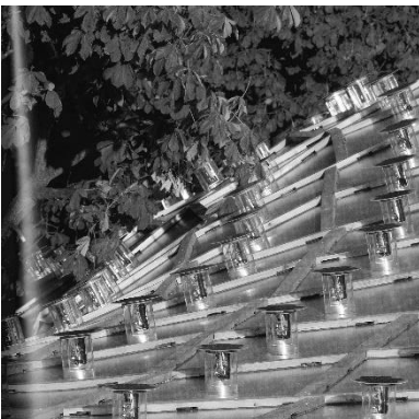
Figura 2.2.5. Luminarias alimentadas por energía solar.
