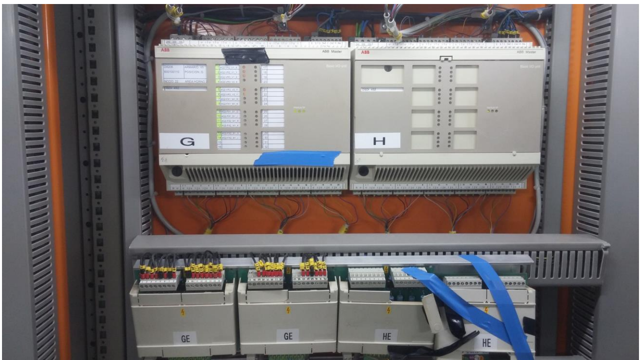
Figura 25. Tarjetas de señales analógicas ABB (imagen de la instalación real)
