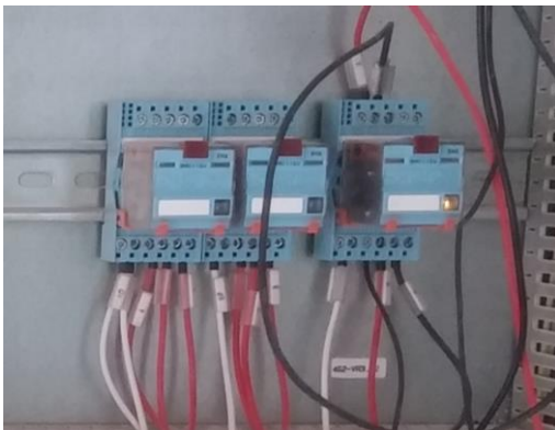
Figura 20. Relés de alimentación (imagen de la instalación real)
