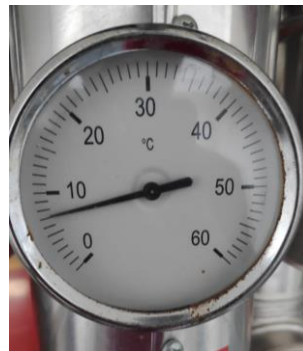
Figura 17: Termómetro bimetálico de la instalación.
