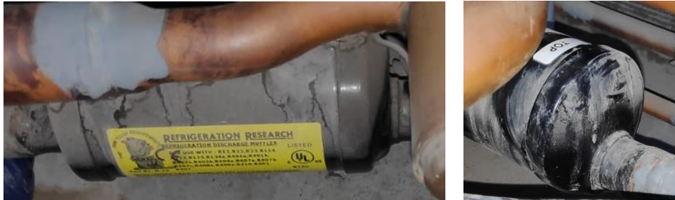
Figura 45: Silenciador de descarga de la bomba de calor.
