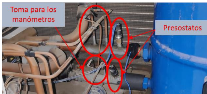
Figura 51: Presostatos y toma de los manómetros.
