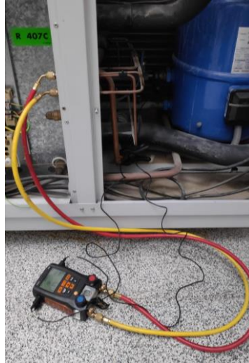
Figura 23: Prueba con el Analizador de refrigeración Testo 550.
