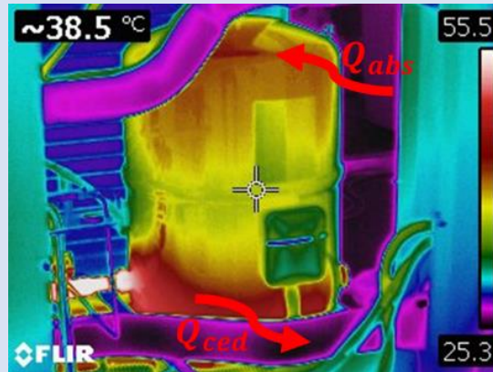
Figura 88: Termografía del compresor completo.
