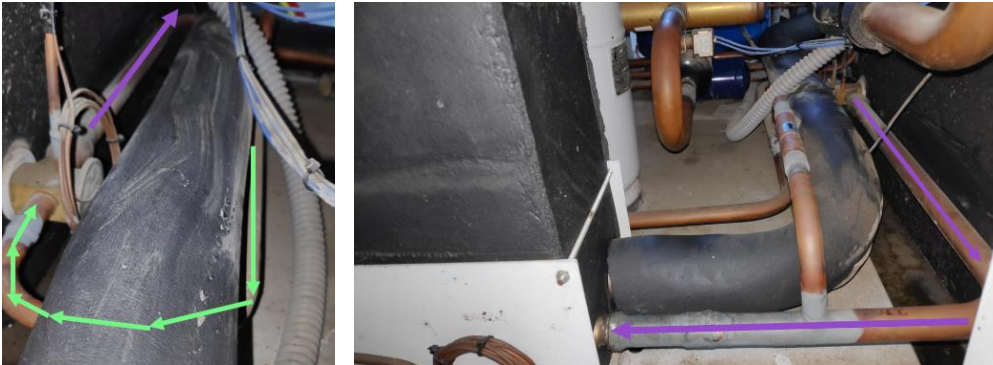
Figura 66: Válvula de expansión del modo frío.
