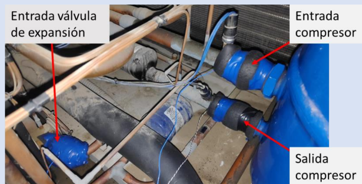
Figura 79: Colocación de las sondas de temperatura en modo refrigeración.
