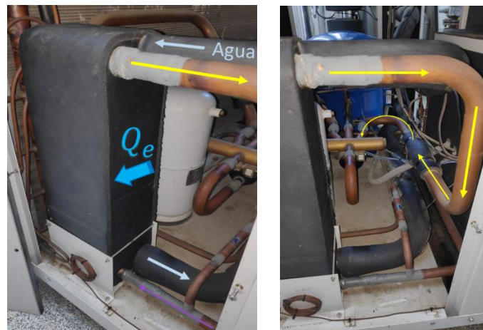
Figura 67: Intercambiador interior en modo frío.
