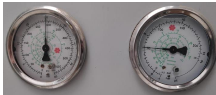
Figura 18: Manómetros fijos de la bomba de calor.
