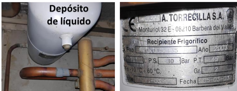
Figura 47: Depósito de líquido de la bomba de calor.
