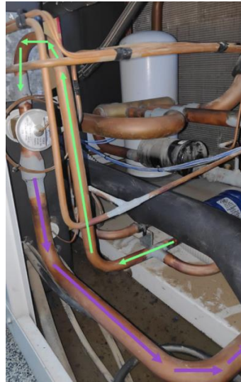
Figura 60: Válvula de expansión del modo calor.
