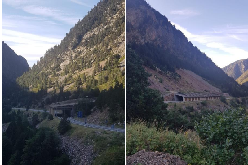
Figura 3 y 4. Defensas contra aludes en la carretera A-138. Autor: Daniel Oсталé Arilla.
