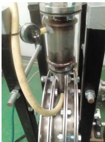
Figura 2. El decantador, por encima del intercambiador de placas.
