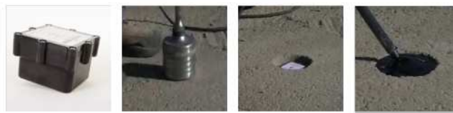
Fig. 9 Instalación de un nodo con acelerómetro [28]
