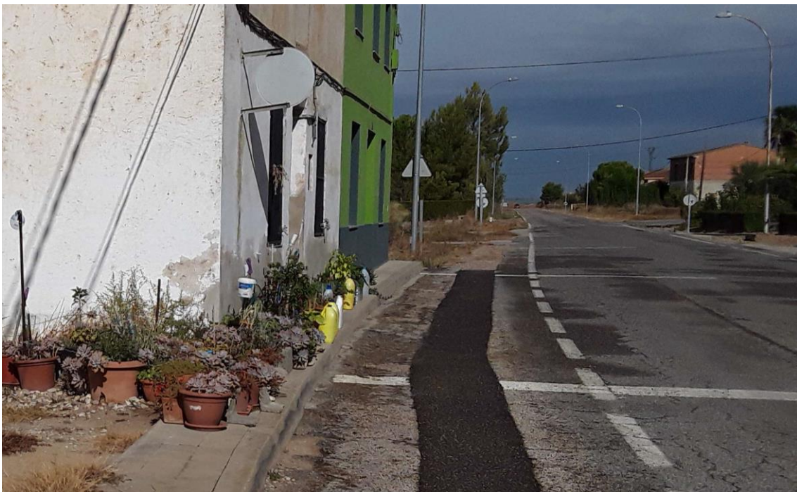
Figura 9. Fotografía del estado de una carretera tomada en campo. Elaboración GEOT
