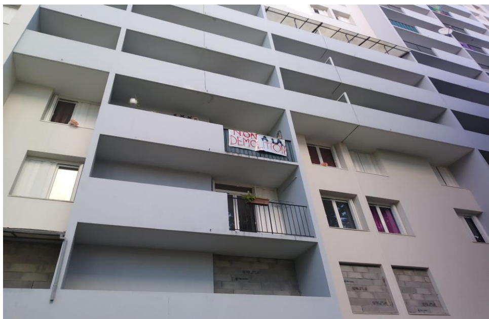
Fig. 25: detalle de la fachada de la torre Isabe; ventanas tapiadas y pancarta. Fuente: elaboración propia, 2018.
