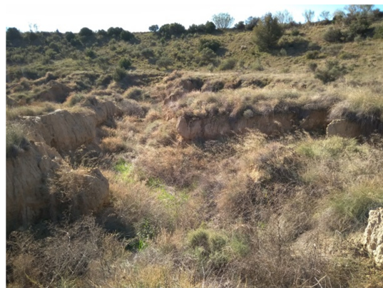
Figura 19. En primer término área acarcavada. Al fondo talud vegetado de la parcela 10.
