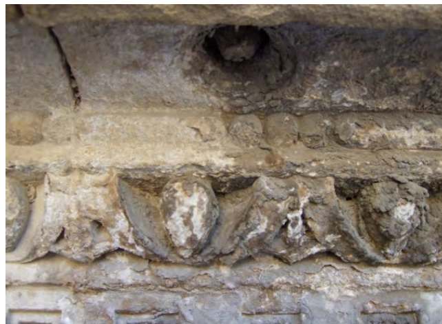
Figura 2. - Ejemplo del deterioro por acumulación de sales, con pérdida de volumen de la zona de labra. El detalle corresponde a la localización de la muestra UNSM-1 en la figura 3.
