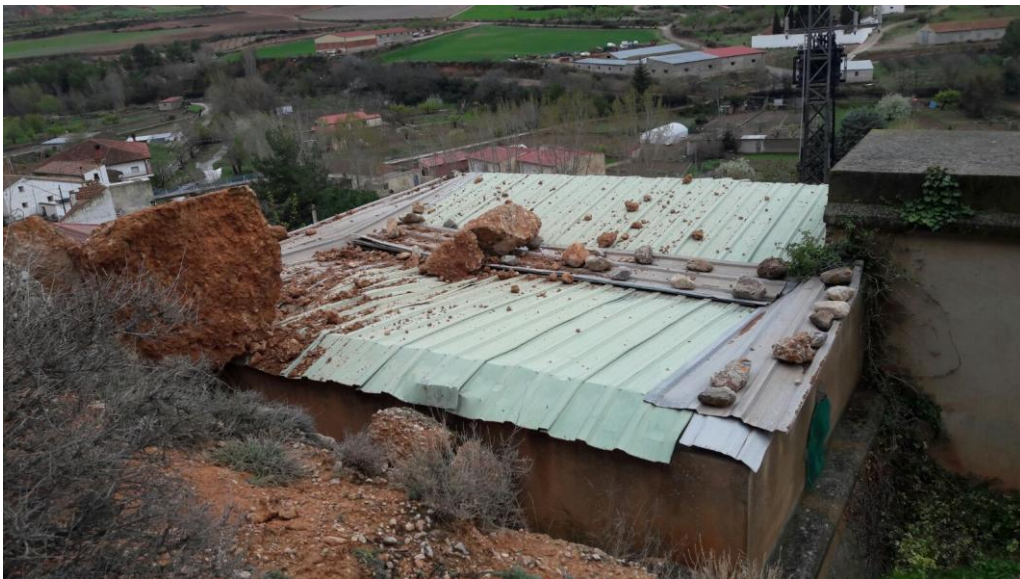
Imagen 16. Desprendimientos sobre el depósito viejo.
