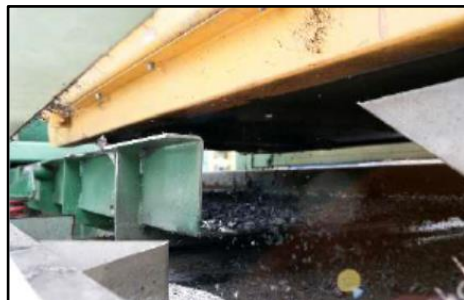
Fuente: Planta de Reciclados Grupo Hormisa Ilustración 17: Cinta Magnética
