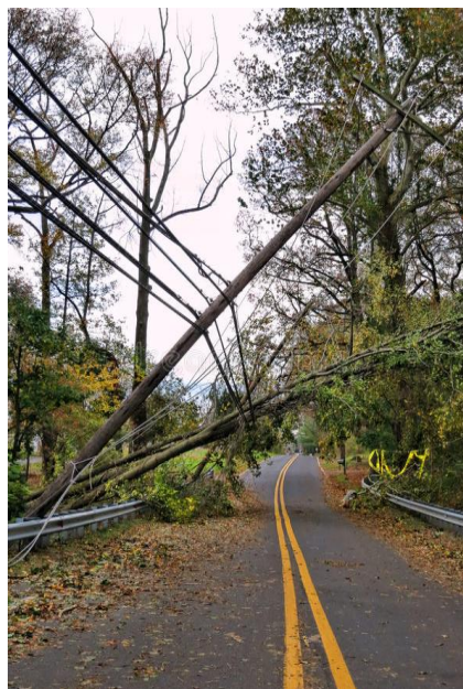
Figura 3. Daño provocado por un árbol a la línea telefónica.
