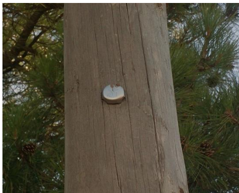
Figura 10. Chivato en poste de madera.
