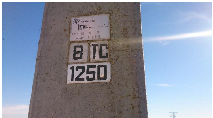
Figura 11. Chivato en poste de hormigón.
