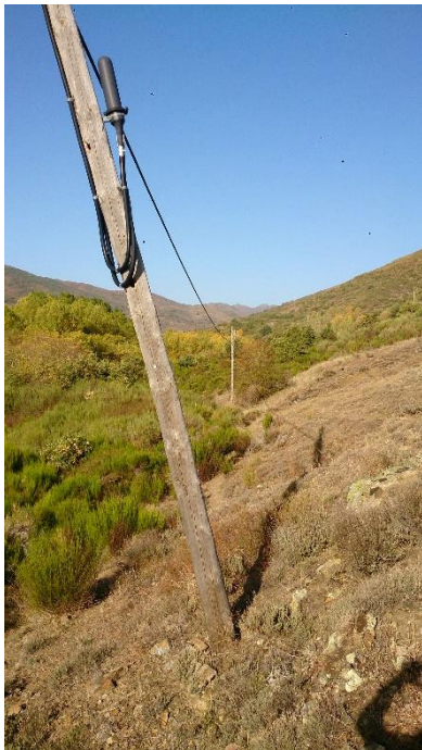
Figura 20. Inestabilidad del poste.
