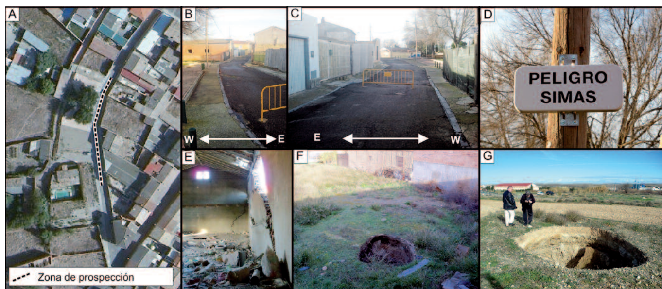
Fig. 2.- (A) Zona de estudio. Fotografías de la zona de estudio. (A) y (B) Aspecto de la zona de estudio vedada a la circulación. (C) Indicativo vial sobre la peligrosidad de la calle. (D) Aspecto de las edificaciones próximas. (E) Colapso en el entorno urbano. (F) Colapso en suelo agrícola en las proximidades de la zona de estudio.
