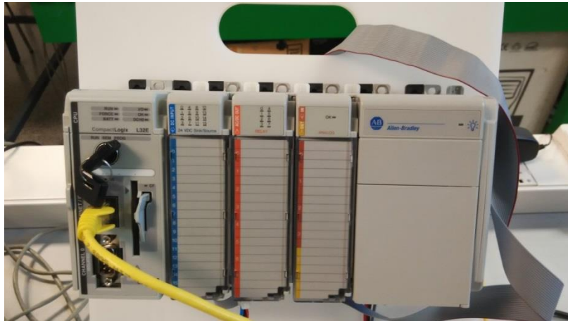
Figura 12. Controlador Compact Logix 1768-L32E
