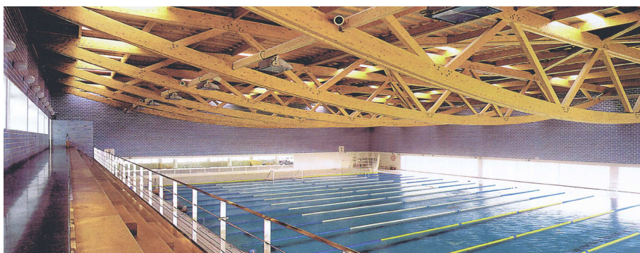
Fig 8. Piscinas Sant Sebastià, Barcelona. Vista interior de la estructura de la cubierta sostenida mediante cerchas de madera laminada
