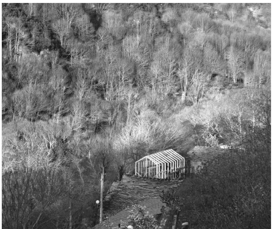
Fig 243: Casa en Paderne, La Coruña. Imagen de la construcción de la vivienda de madera.
