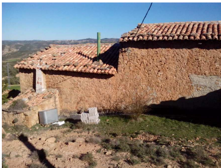
Ilustración 79: Salida chimeneas al exterior.
