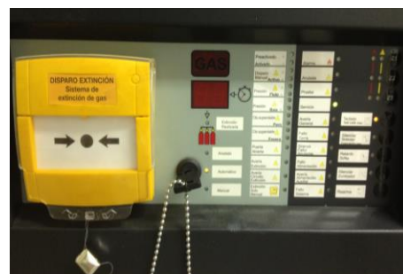
Figura A7. 9. Central de control de extinción de incendios
