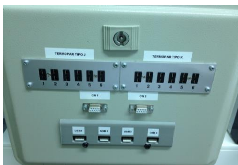
Figura A7. 6. Panel de conexiones interior/exterior de la sala.
