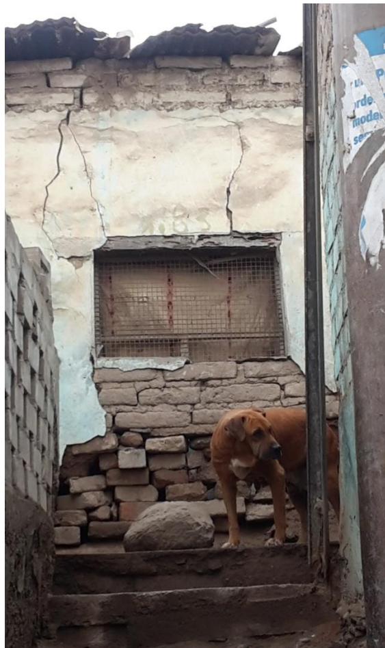
Imagen 10: Construcción habitada en ruinas en el cerro de San Cristóbal.
