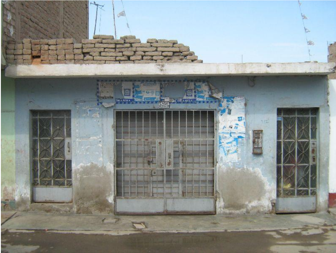
Imagen 7: Construcción de ladrillo afectada por humedad basal.
