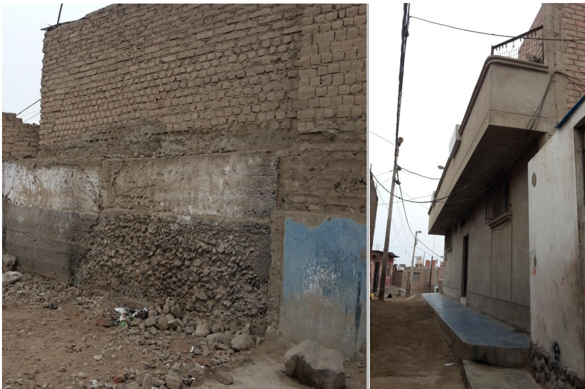
Imagen 2: Vista lateral de la vivienda (izquierda), que evidencia una construcción con materiales detríticos débilmente compactados y escasamente resistentes en caso de sismo; y vista de la fachada de la vivienda (derecha).
