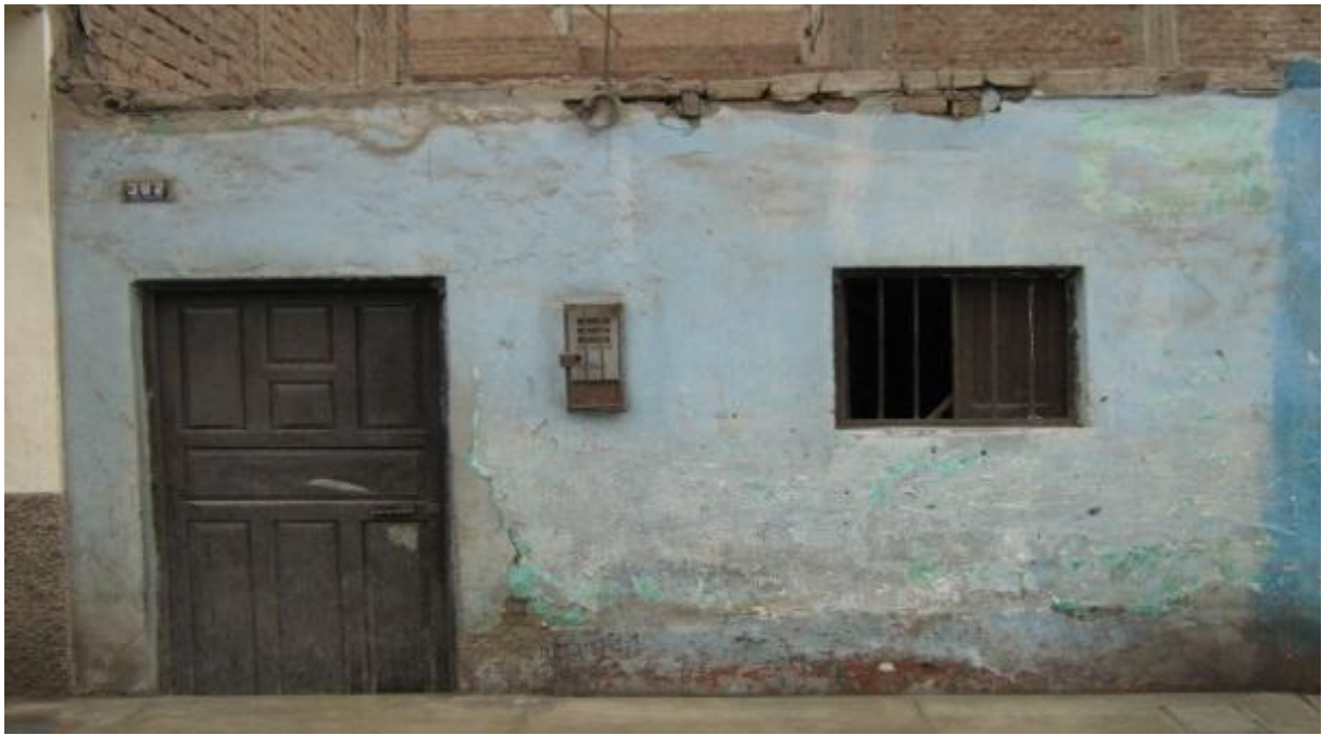
Imagen 6: Construcción de adobe con grietas.
