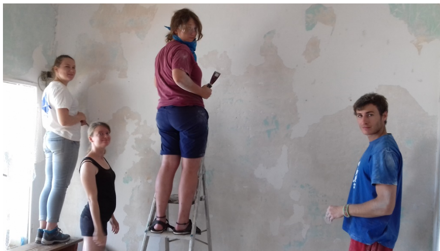
Figura 9. Rehabilitación del recibidor de la casa de voluntarios, proceso de decapado y lijado de capas de yeso desprendidas.
