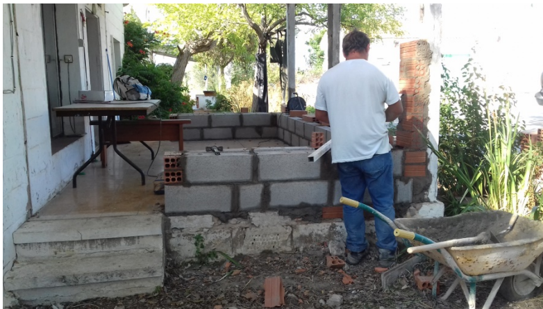
Figura 7. Reconstrucción y afianzado de vigas del porche de entrada por personal externo contratado.
