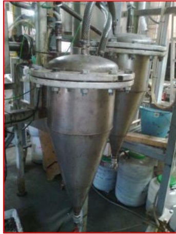
Figura 27. Expansores instalados en la planta piloto utilizada para llevar a cabo el proceso de pirólisis de biomasa y NFU.
