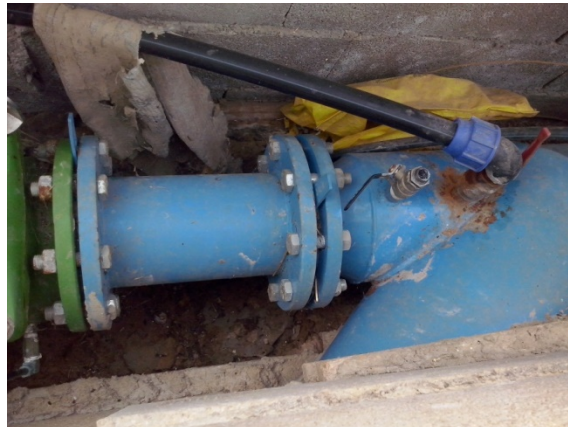
Figura 5. Toma de riego en hidrante actual
