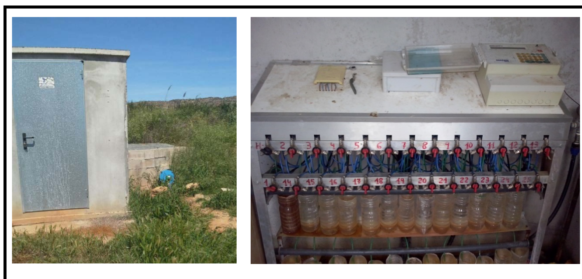
Ilustración 1. Caseta de riego ( izquierda ) y programador de riego ( derecha )
