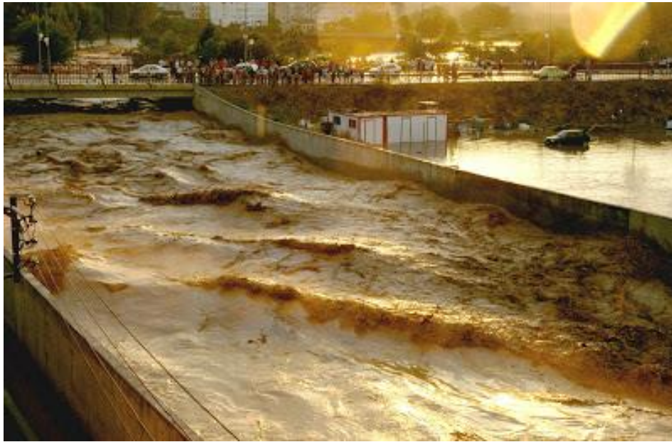
Fotografías 8 y 9. Los muros de contención del río el día 15 de Agosto de 2006 en la crecida
