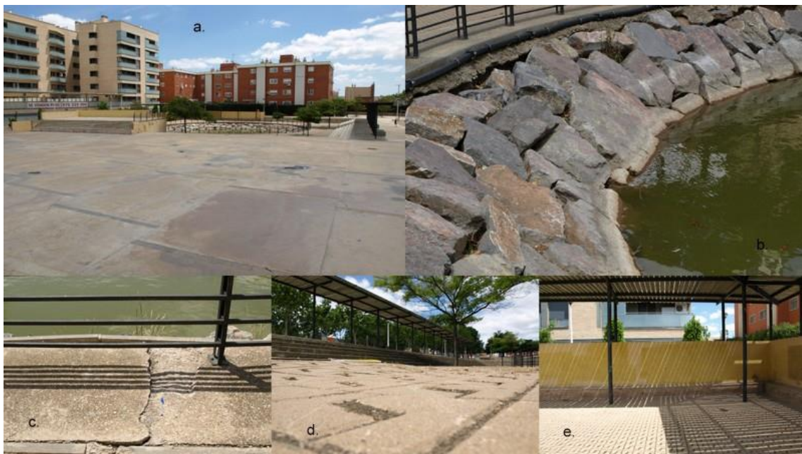
Figura 30. Dolina 27. Partes: a. Visión general de la dolina. b. Hundimiento de rocas decorativas de la dolina hacia el fondo. c. Grieta de gran tamaño en el suelo; de referencia se usa un bolígrafo BIC. d. Ondulaciones en el suelo debidas a la dolina. e. Reparaciones múltiples en los muros de las cercanías. Fuente: elaboración propia.
