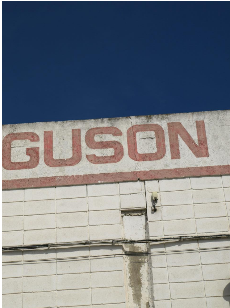
Figura 27. Dolina 22. Grieta milimétrica que recorre toda la fachada del edificio. Fuente: elaboración propia.
