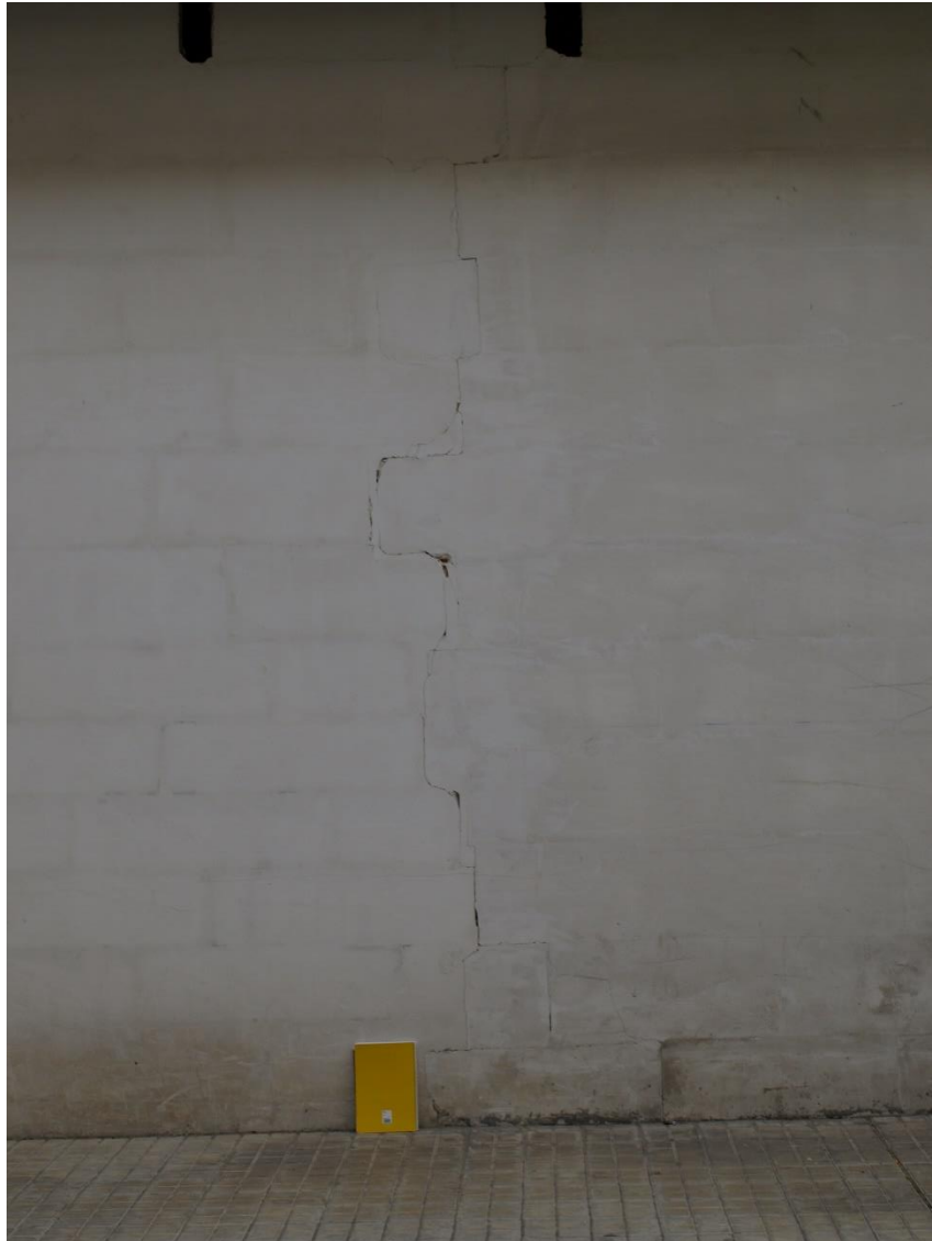
Figura 23. Dolina 18. Grieta de milimétrica a centimétrica. El cuaderno de referencia es tamaño A4. Fuente: elaboración propia.
