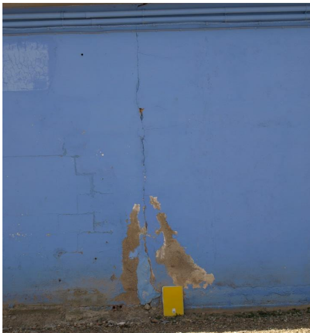
Figura 29. Dolina 26. Grieta centimétrica en el muro del estadio de futbol Santa Ana. Como referencia se usa un cuaderno tamaño A4. Fuente: elaboración propia.
