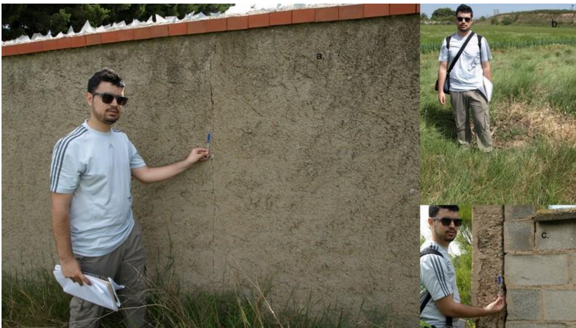
Figura 16. Dolina 8. Partes: a. Grietas milimétricas en la pared de un edificio situado dentro de la dolina en su margen Oeste. b. Colapso de 1.5 m de diámetro y 40 cm de profundidad en el margen de la dolina. c. Grietas centimétricas en un muro de una vivienda situada en la parte oriental de la depresión.
