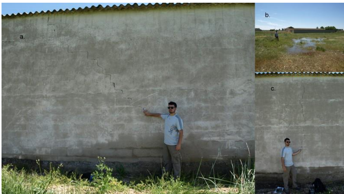
Figura 19. Dolina 14. Partes: a. Grietas de milimétricas a centimétricas en un muro. b. Lámina de agua. c. Grietas centimétricas en el mismo muro.
