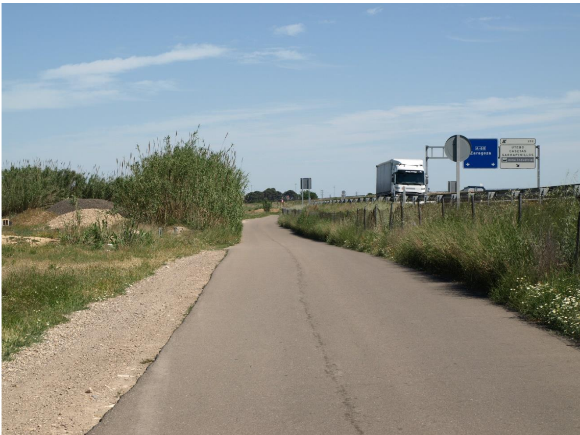
Figura 17. Dolina 9. Se observa la flexión de la autovía.
