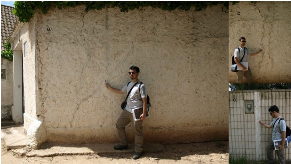
Figura 18. Dolina 10. Partes: a. Grietas milimétricas en la pared norte del edificio. b. Grietas centimétricas en un muro de otra vivienda al este de la vivienda anterior. c. Grieta reparada con yeso que se ha vuelto abrir de manera milimétrica. Fuente: elaboración propia.
