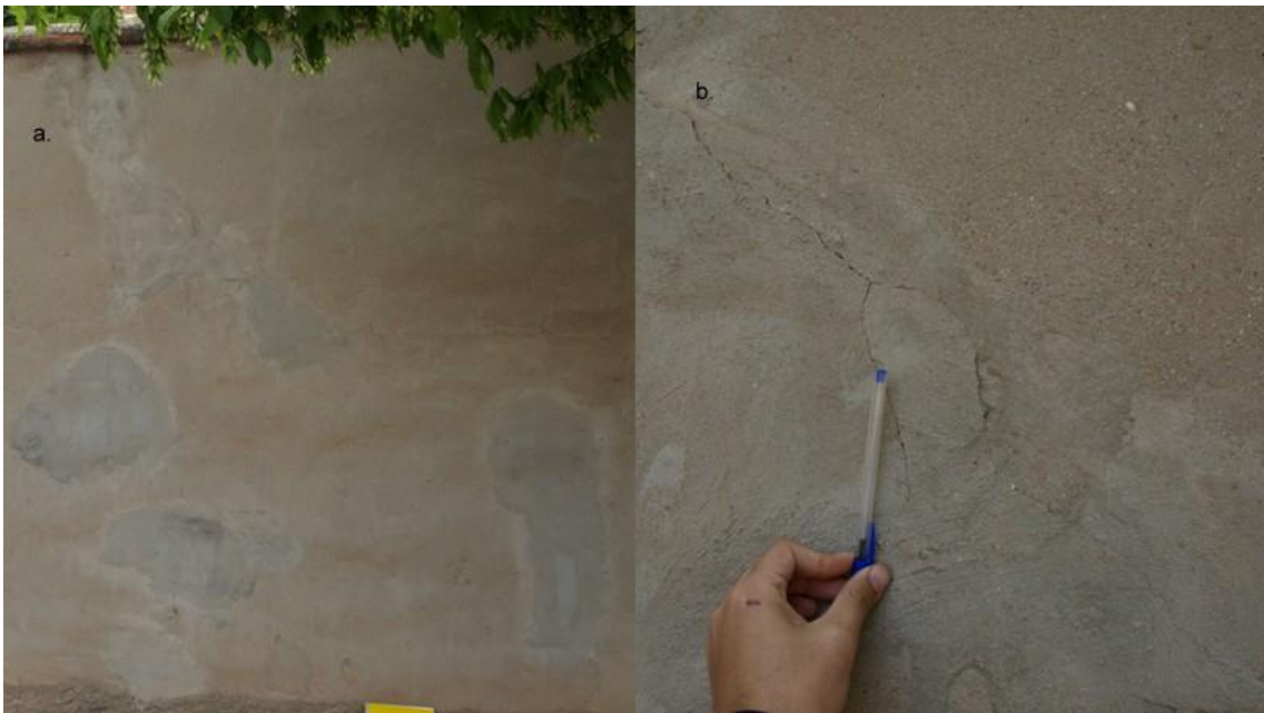
Figura 24. Dolina 19. Partes: a. Grietas reparadas. b. Grieta milimétrica que ha reaparecido sobre la reparación. Se usa como referencia un bolígrafo BIC Fuente: elaboración propia.
