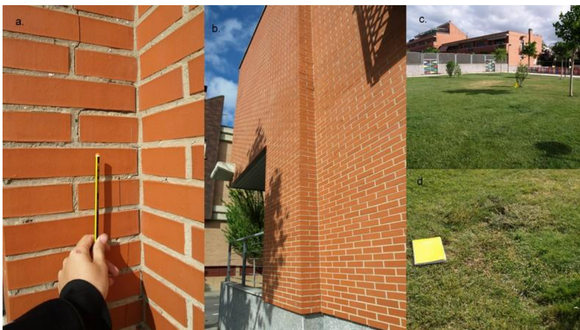
Figura 22. Dolina 17. Partes: a. Grietas de milimétricas en un muro. b. La grieta recorre todo el edificio. c. Visión general de la dolina. d. Socavón, de referencia se utiliza un cuaderno tamaño A4. Fuente: elaboración propia.
