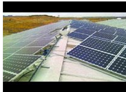
Placas fotovoltaicas de la Empresa
