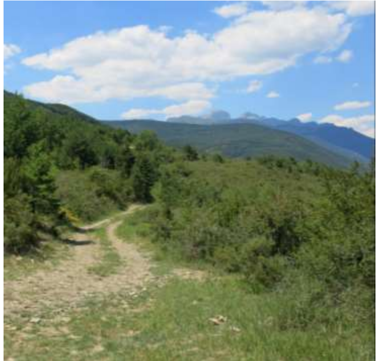
Figura 8: En la parte derecha de la imagen se observa un rellano producido por el deslizamiento seguido de un escarpe orientado ladera abajo.
