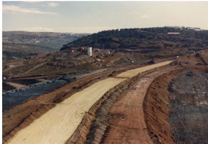
Figura 5.11 Disposición de los diferentes materiales empleados durante la construcción de presa de materiales sueltos de núcleo (9)
