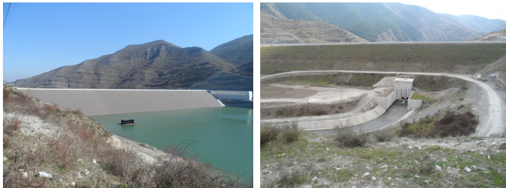
Figura 5.12. Paramentos aguas arriba (izquierda) y aguas abajo (derecha) de presa de materiales sueltos de pantalla
