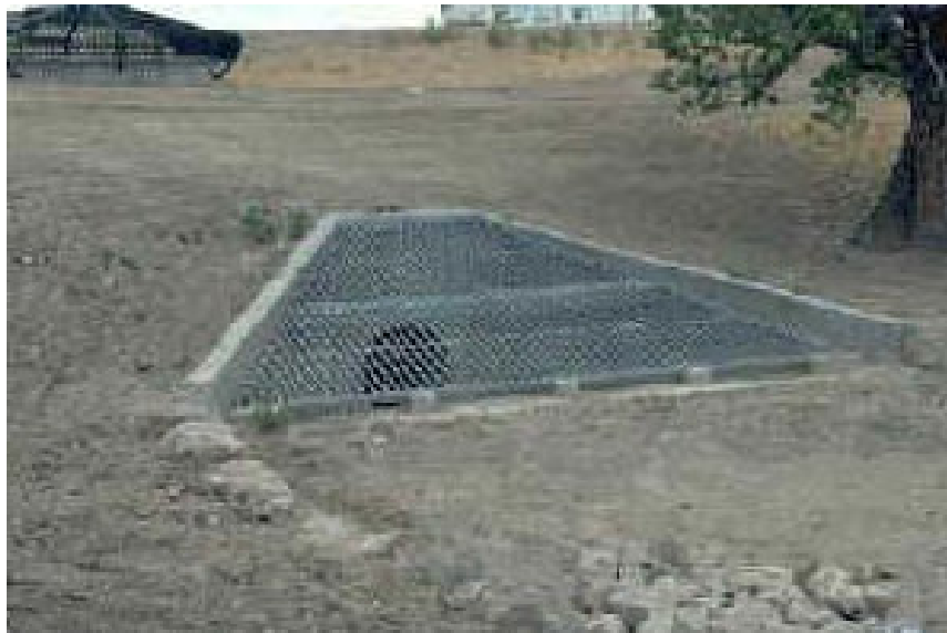
Ilustración 8.6 – Rejas entrada colector subterráneo.
