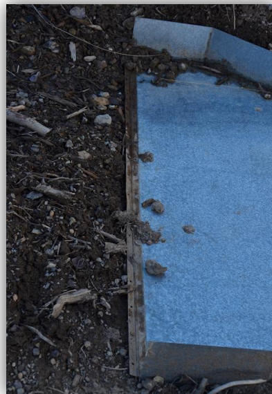
Fotografía 25. Detalle de boca de rana desplazada.
