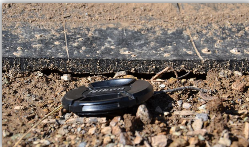
Fotografía 18. Grieta de contacto en la canaleta de la trocha 1.
