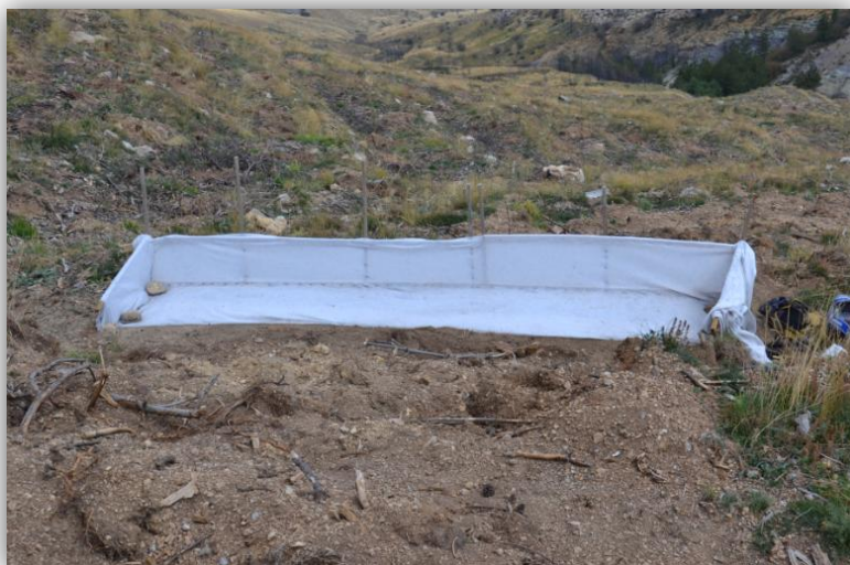
Fotografía 30. Trampa de geotextil en la trocha 2.
