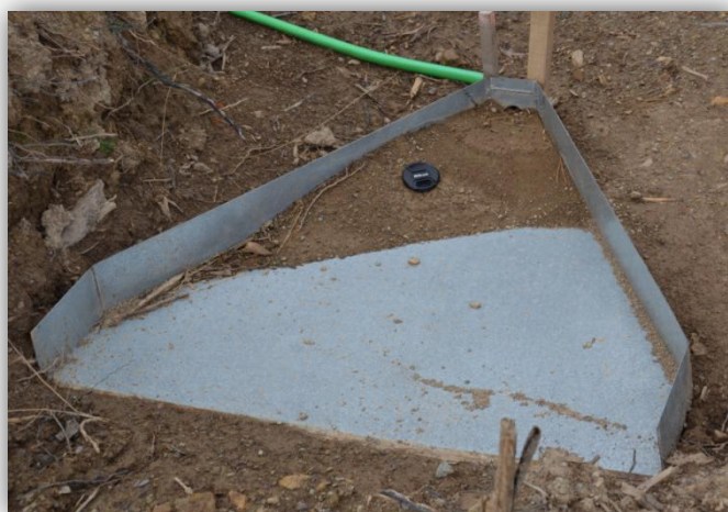
Fotografía 21. Obstrucción de la boca de rana izquierda (7/11/2013).
