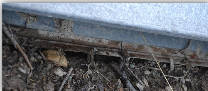
Fotografía 26. Grieta en el contacto boca de rana-sustrato.
