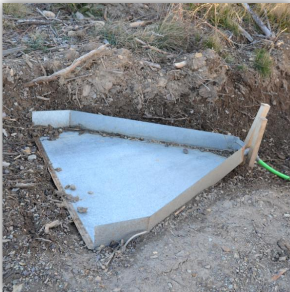
Fotografía 24. Boca de rana desplazada.
