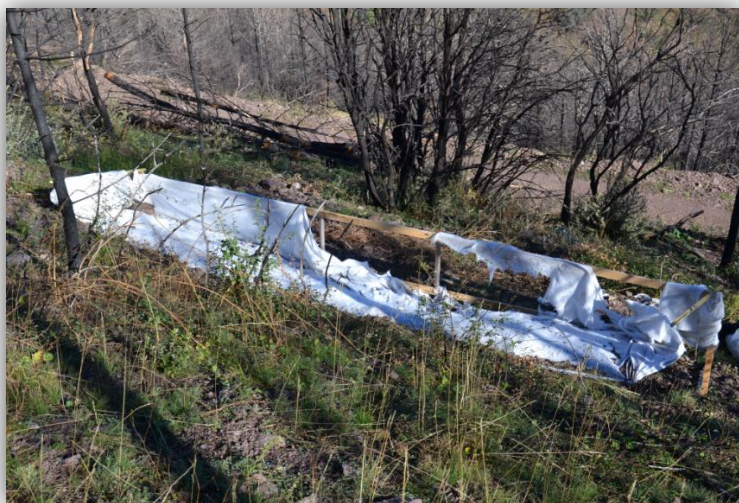
Fotografía 32. Geotextil después de la tormenta del 4 de octubre.
