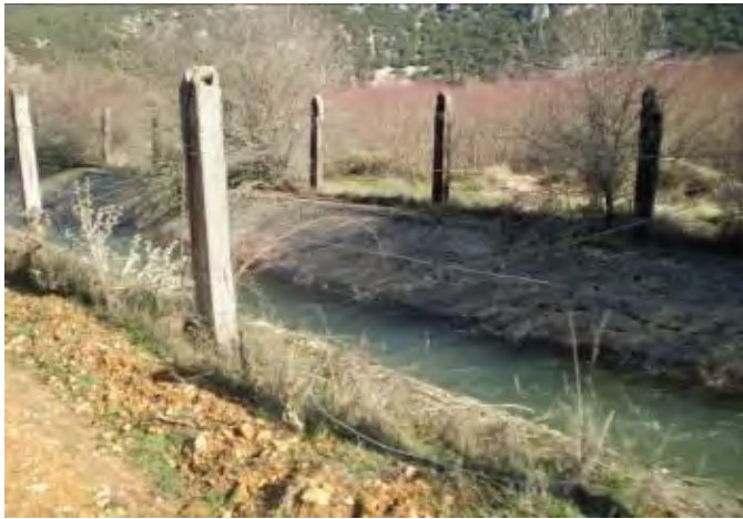
Infraestructuras de canalización de la laguna
