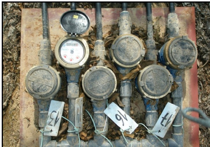
Figura 2.4. Contadores volumétricos instalados en una línea de árboles para la medida del riego aplicado en las dos líneas portagoteros de los tratamientos de riego T1, T2 y T3.
