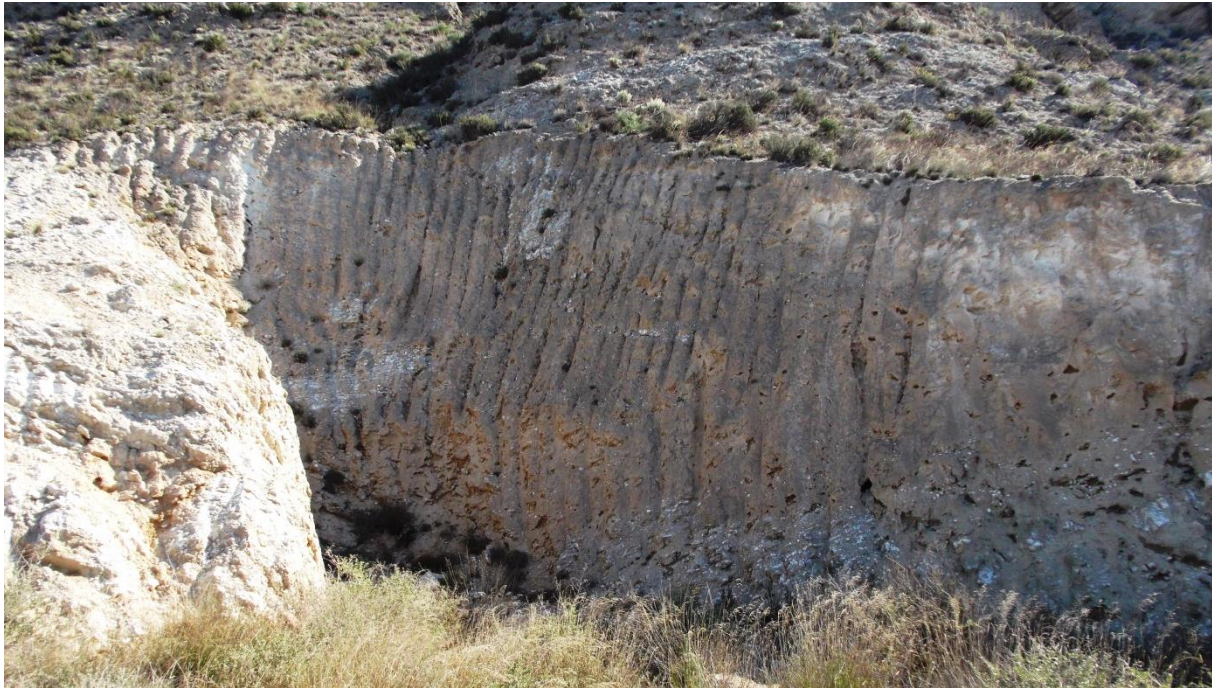
Fig. 11.- Trinchera realizada por las obras de la ARA-A1 en un cuerpo deslizado. En esta trinchera se observa un deslizamiento rotacional con una gran potencia de relleno y material de glaciares fosilizándolo en la parte superior.
