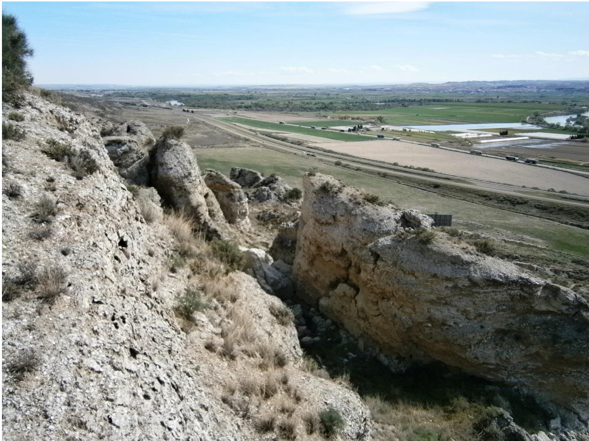
Fig. 9.- Sistema de deslizamientos complejos (spreading+deslizamiento rotacional) en el cuerpo activo de nuestra zona de estudio. En esta imagen se ve claramente el gran espacio creado entre bloques (9m) debido al desplazamiento lateral de los cuerpos. Nos encontramos ante un bloque de unos 4m de altura en su parte posterior y unos 120\text{m}^3 de volumen. Podemos observar que el bloque todavía no se haya muy rotado a pesar de la gran apertura entre ellos, lo cual sería indicativo del bajo valor del rozamiento del plano inferior en esa zona.
