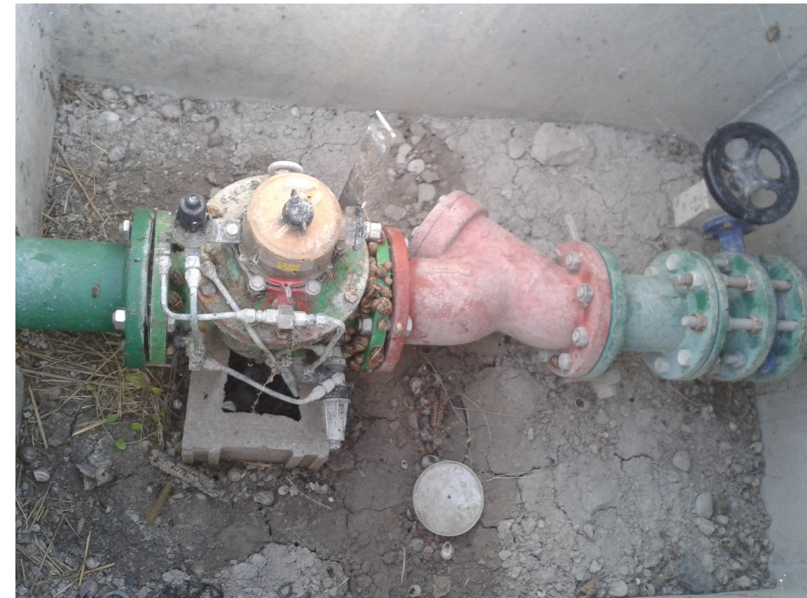
Figura 1. Situación actual de los hidrantes
