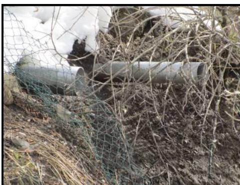
Figura 12. Detalle de las tuberías procedentes del Parador Nacional que vierten al río Cinca en el punto C.1 (invierno).
