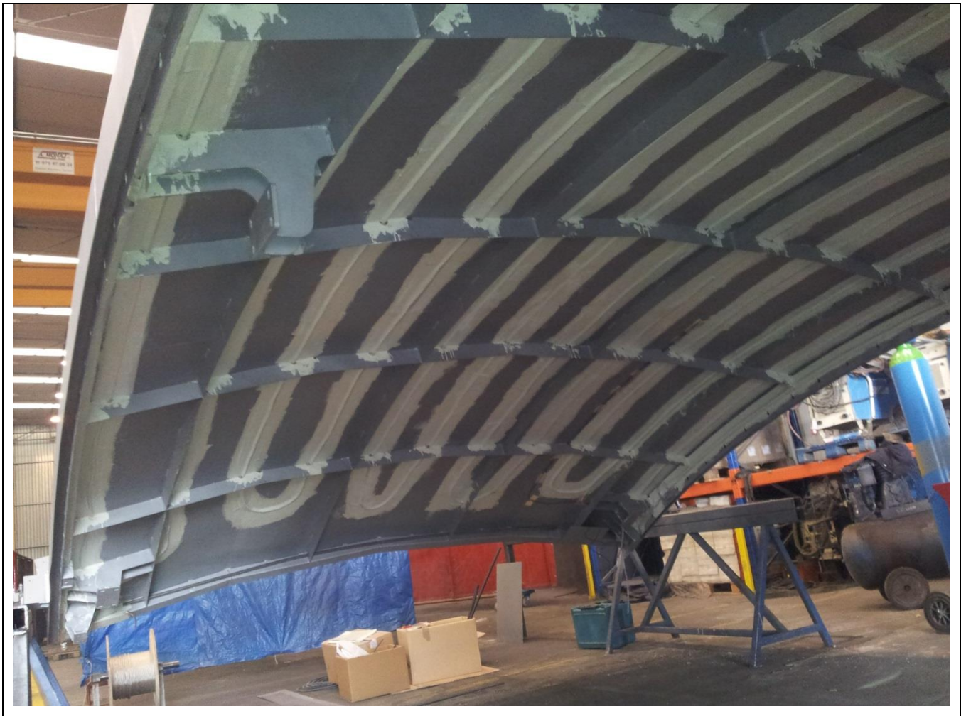
Fig. 3.9.5 – Disposición real del cable calefactor en la compuerta interior
