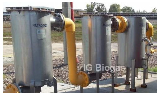
Figura 25 Filtros de Biogás
