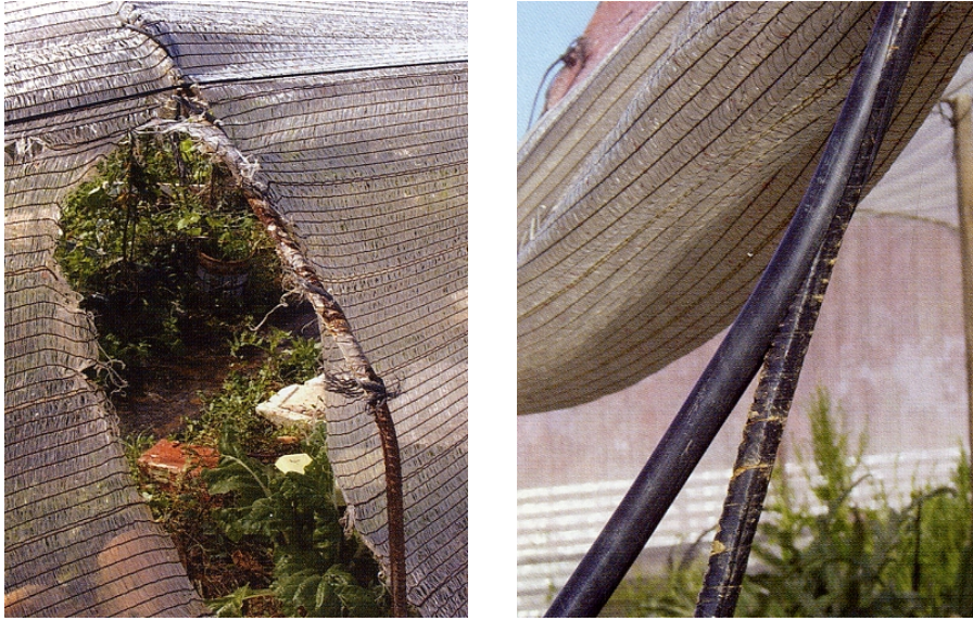
Fig. 8- Detalle de la rotura de la malla térmica por el efecto lija provocado por la oxidación del hierro corrugado, (dcha.). Protección del hierro corrugado con una tubería de plástico (izda.)
