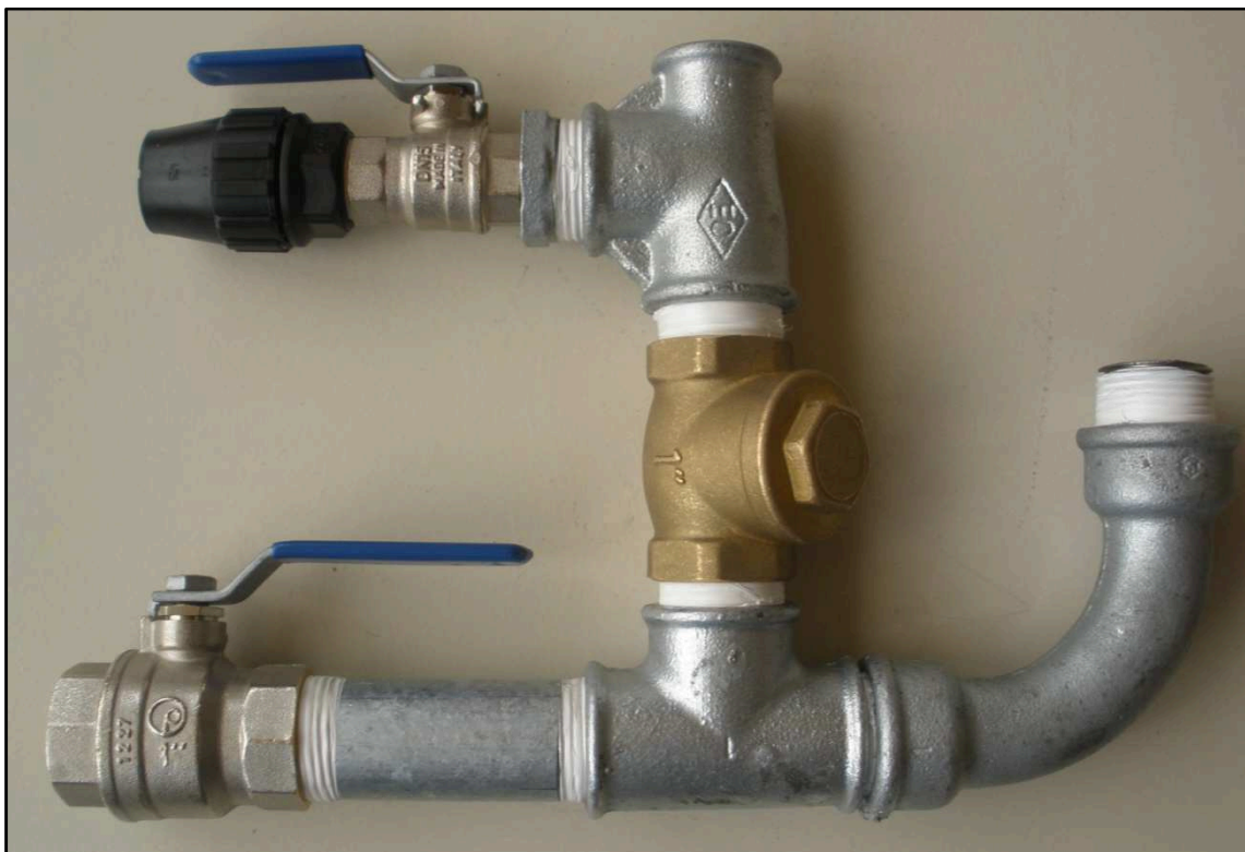
Figura AI.10. Salida de agua instalada con el acople de 1/2" de PE [Fuente: Propia]
