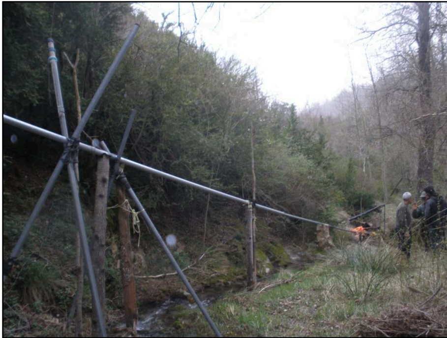
Figura 2.44. Tubería de impulso de la instalación [Fuente: Propia]
