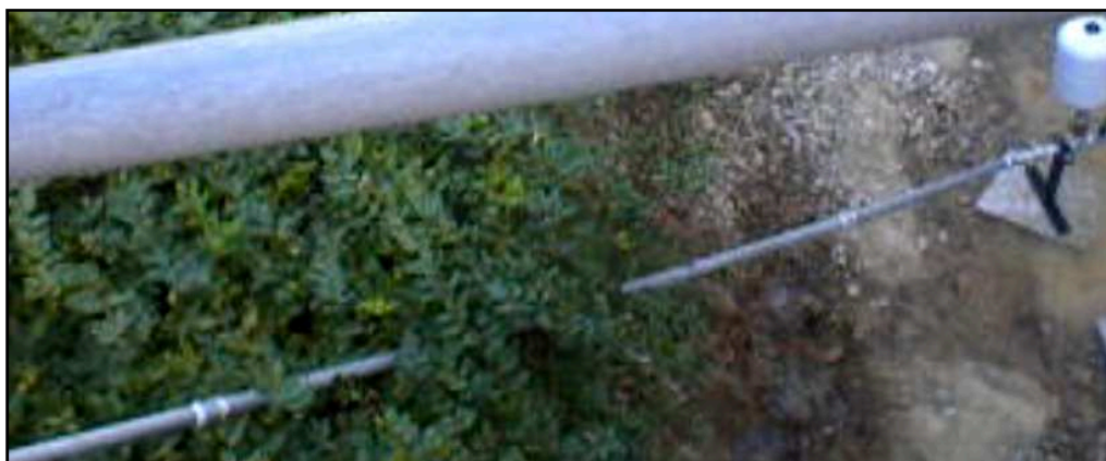
Figura 3.11. Tubería de impulso [Fuente: Propia]
