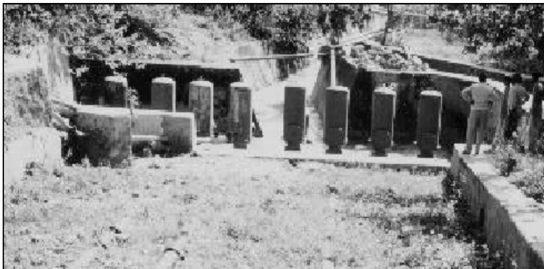
Figura 2.36. Ocho bombas de ariete instaladas en paralelo en Dehradun, India [Fuente: Chi (2002)]
