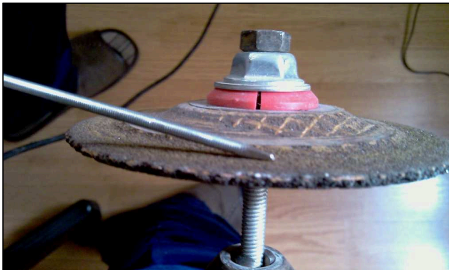
Figura AII.11. Afilando la varilla roscada en un extremo con un taladro [Fuente: Propia]
